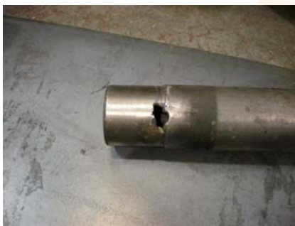
損壞了的冷卻管
